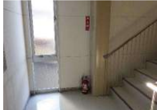
消火器設置場所【建屋2階】
