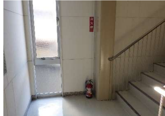
消火器設置場所【建屋2階】
